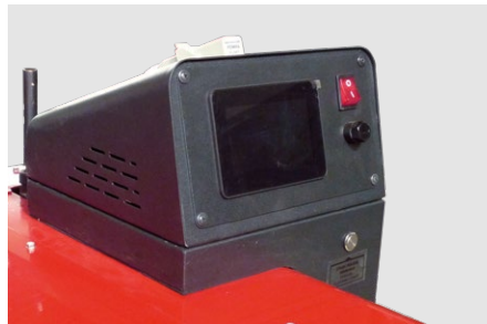
Panel de control de caldera con pantalla táctil
